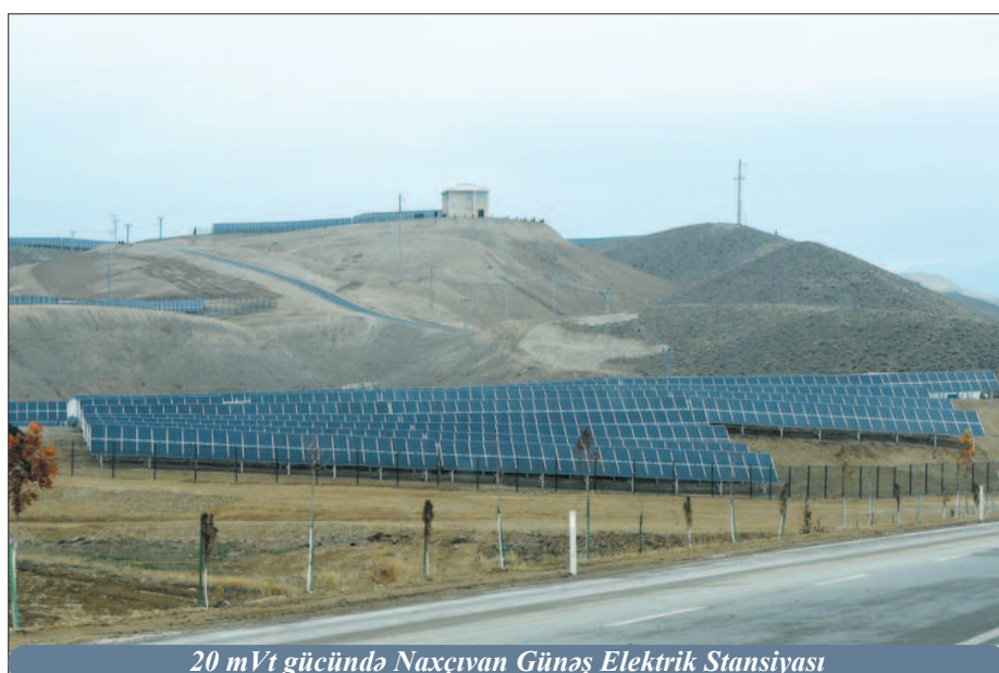
20 mVt gücündə Naxçıvan Günəş Elektrik Stansiyası
